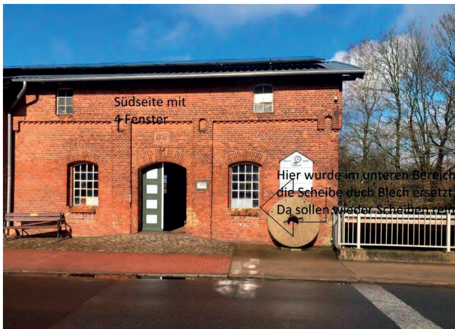
Die Südseite der Mühle mit den 4 Fenstern. Hier wurden im unteren Bereich die Scheiben durch Blech ersetzt. Diese sollen wieder mit Scheiben erneuert werden.
